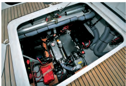
↑ La cale moteur tribord accueille le parc de batteries servitude. Notez le coupe-circuit moteur de la nouvelle génération common rail et le carter-marchepied noir. Le capot sandwich a permis la suppression du faux plancher d'isolation
